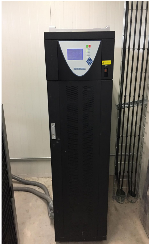
Sistema de respaldo UPS
