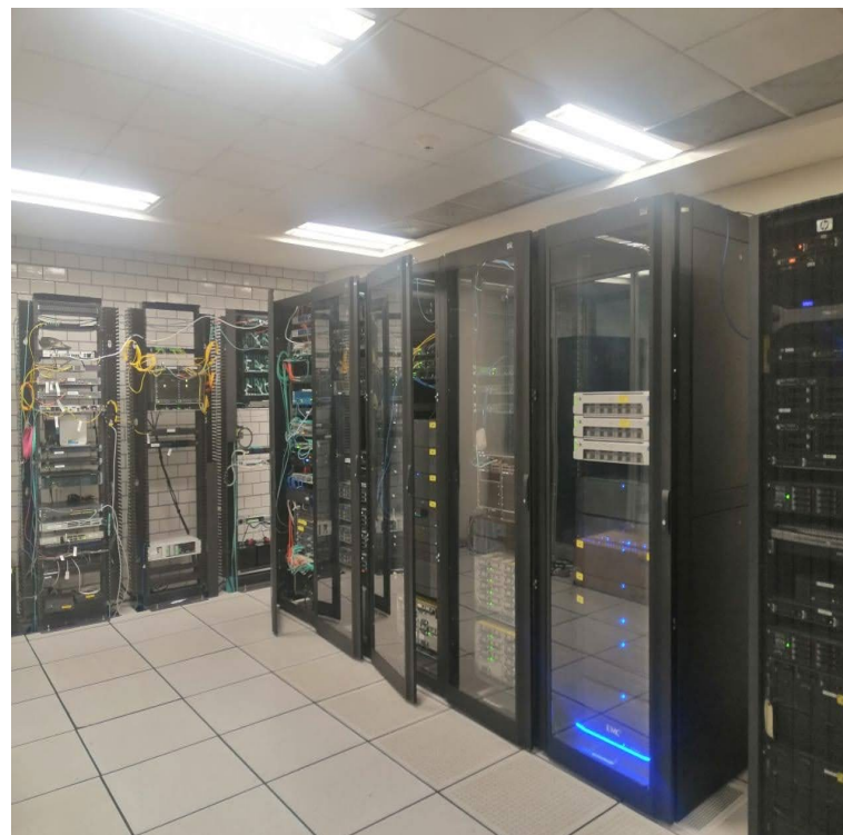
Vista general del DataCenter
